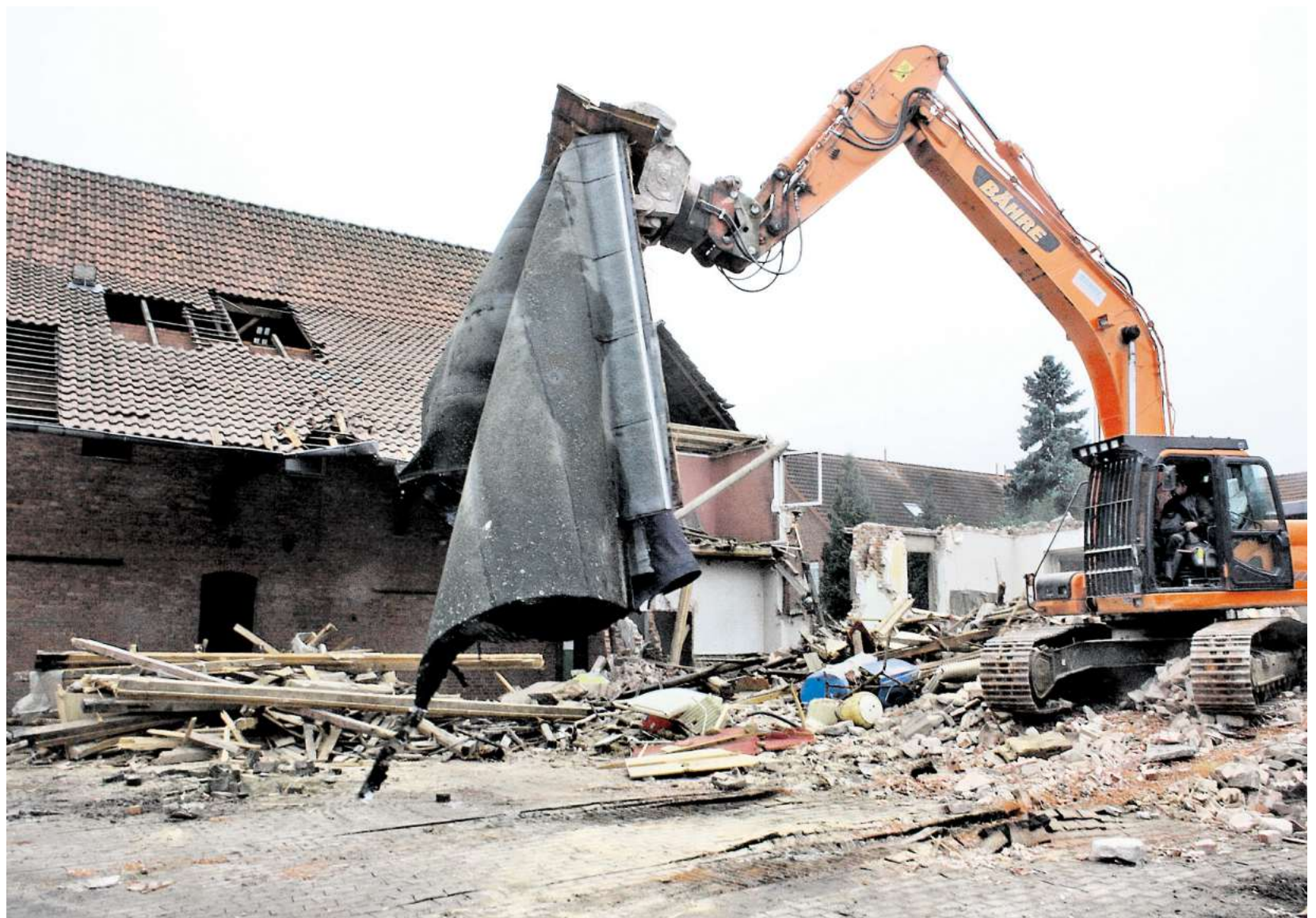
Ende einer Hofstelle: Baggerfahrer Lucky von der Firma Bähre macht der alten Hofstelle an der Backhausstraße 4 den Garaus.
